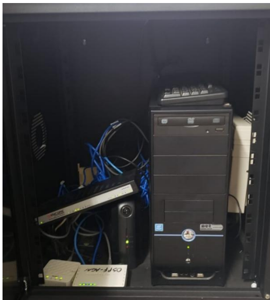
Figura 4 - Local de Instalação
